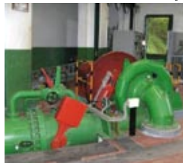
LLEGADA DE LA TUBERÍA FORZADA EN UNA PEQUEÑA CENTRAL HIDROELÉCTRICA – Fotografía: Xabier Cabezón (2006)
