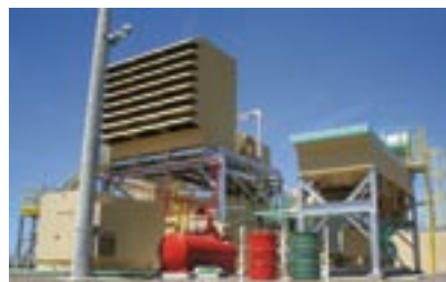
TURBINA DE GAS. Fotografía Joaquín Turco
