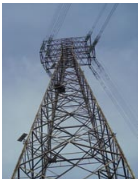
ESTRUCTURA 2 x 220 kV - Fotografía: Joaquín Turco
