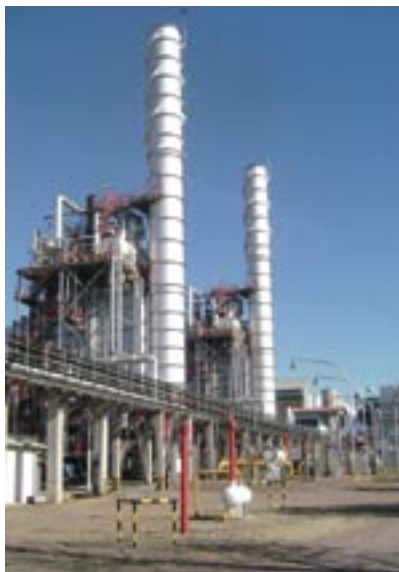
UNIDADES DE COGENERACIÓN. Fotografía Joaquín Turco
