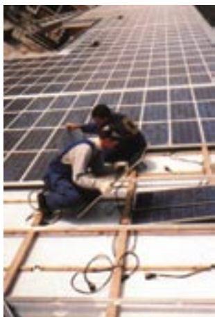
PANELES FOTOVOLTAICOS (SOLARES) Fotografía: Jurgen Koopmanschap – Estudio Gemini
